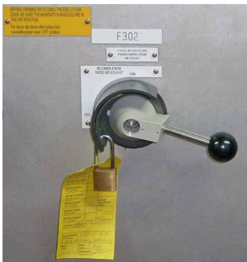
Sådan kan det gøres: Aflåselig forsyningsadskiller hvor den skal bruges, god skiltning og hængelåsen på plads. Låsen (Lock out) er suppleret med skiltning (Tag out), med mærkat med yderligere oplysninger. Foto: Maskinsikkerhed
