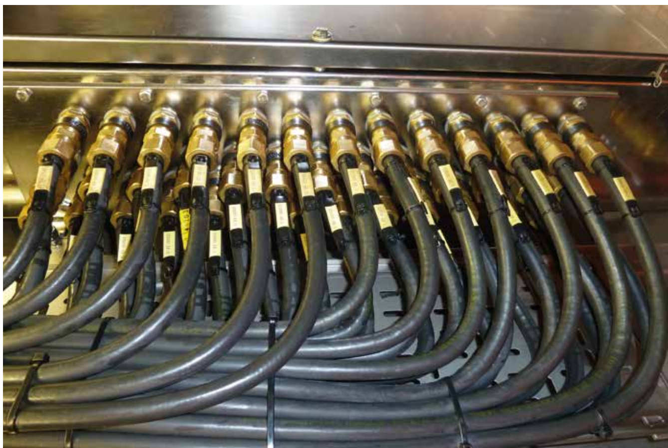
Alle hydraulikslanger er opmærket klart og tydeligt. Det giver overblik, og dermed også mulighed for hurtigt at servicere dele af anlægget, uden at gå på kompromis med sikkerheden. Foto: Maskinsikkerhed
